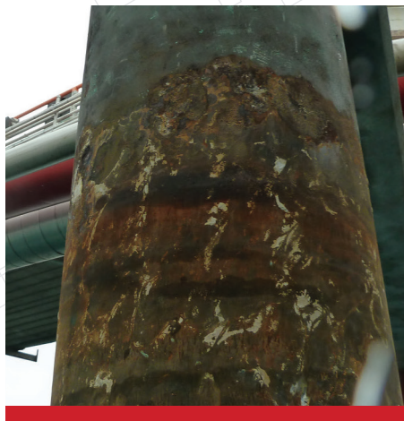
Activos offshore en condiciones de corrosión avanzada.
